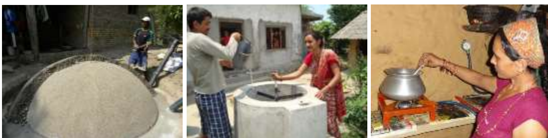
Installations de biogaz en construction et en fonctionnement, réchaud fonctionnant au biogaz. (Source: Atmosfair)
