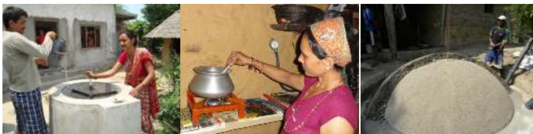
Installations de biogaz en construction et en fonctionnement, réchaud fonctionnant au biogaz. (Source: Atmosfair)
